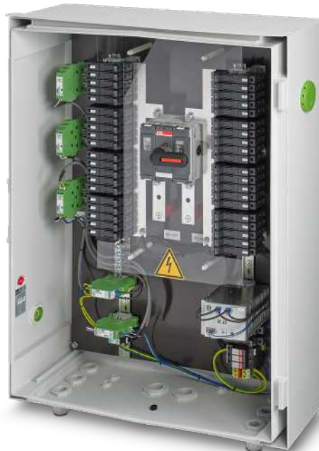
20-kanaals stroommeting (8+8+4) met twee 8-kanaals en één 4-kanaals apparaat
